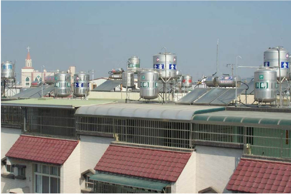
圖 5、透天厝安裝太陽能熱水器
